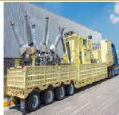
Subestación móvil de 30 MVA, 115/34.5-13.8 kV
